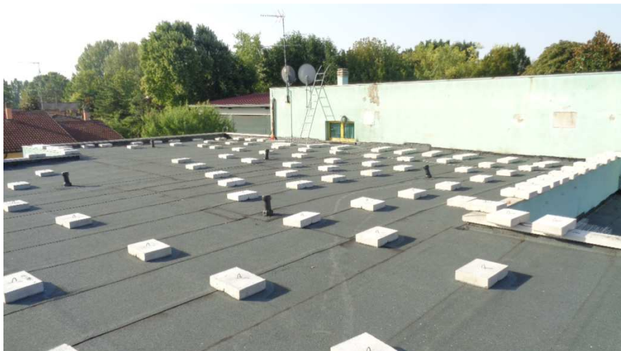
Zavorre impianto fotovoltaico
