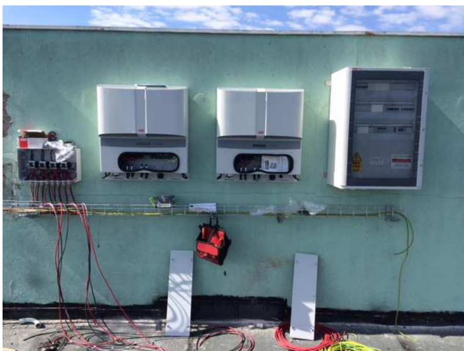
Installazione contatori ed inverter
